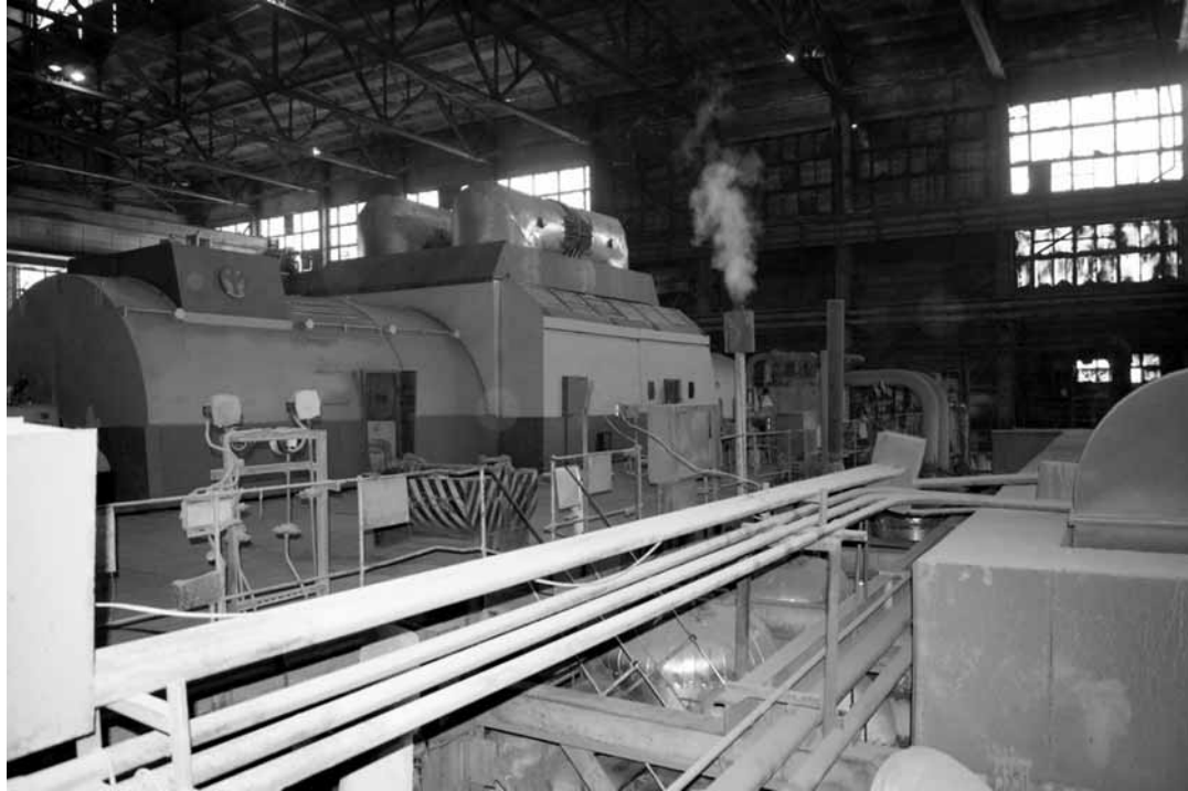
С начала отопительного сезона на ТЭЦ-2 было зафиксировано 49 аварийных остановок котельного оборудования. Фото автора
