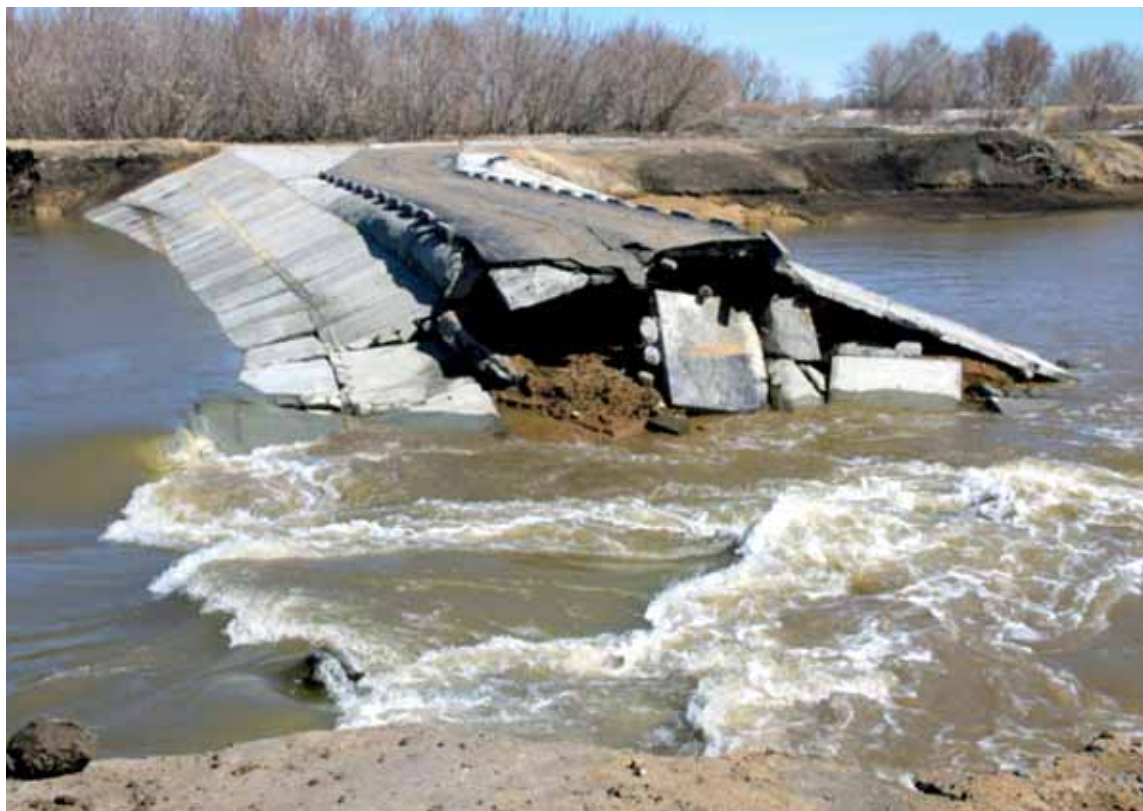
Новую бетонную дамбу, сданную в эксплуатацию в селе Переметное в ноябре 2017 года, смыло спустя пять месяцев. Фото: Рауль УПОРОВ
