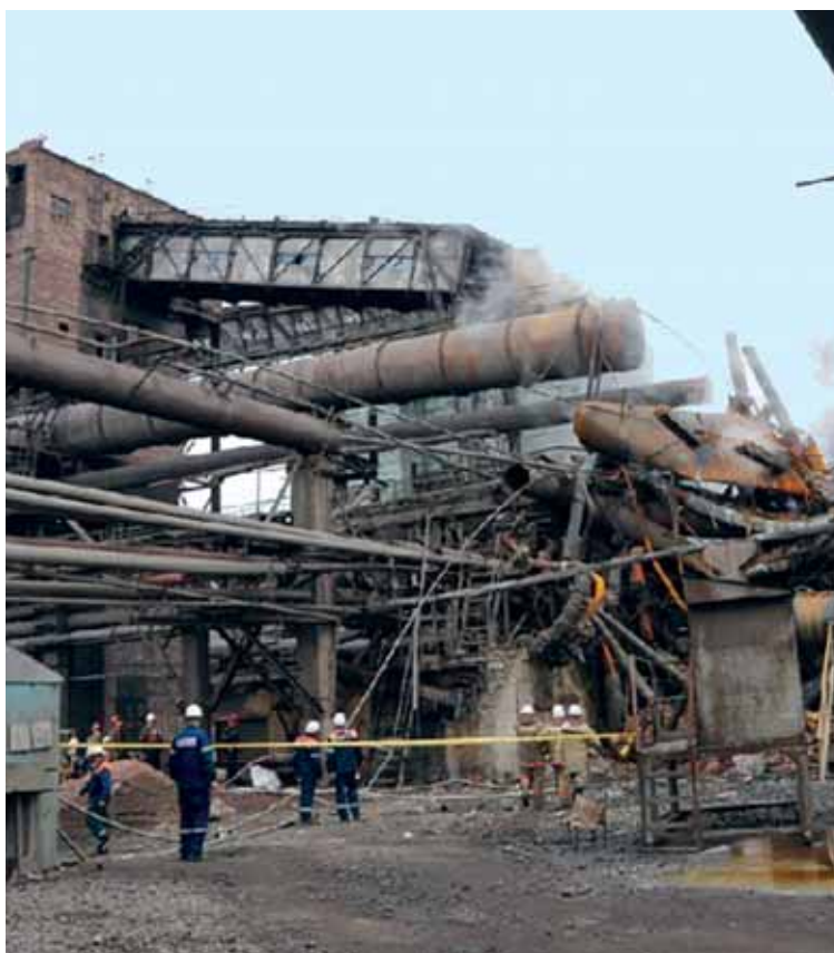
По информации пресс-службы АМТ «Произошло разрушение трубопровода между конвертерным цехом и цехом обжига известняка». Фото: factum.kz
