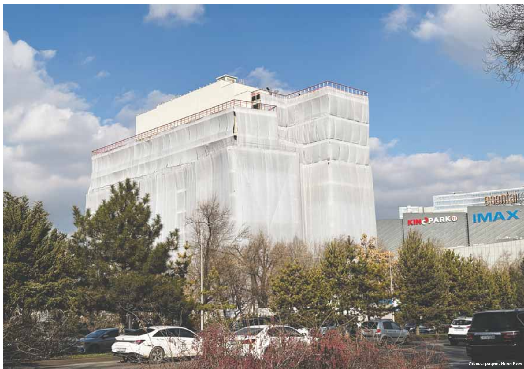
Строительство бизнес-центра Deniz Park класса А+ рядом с Esentai Tower в Алматы приостановлено.
